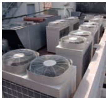
Hotel Dimar, Valencia Sistema de caudal variable.
