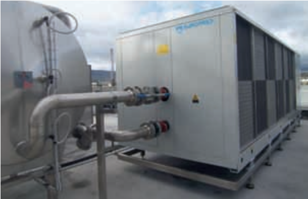
Gascon Vermuyten, Vitoria (Alava) Enfriadora aire-agua compresor tornillo. Potencia instalada 541 kW. Proceso industrial de enfriamiento de la nata.
